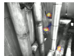
플랜트 산업 배관 유지 보수 (다발성 누설)
