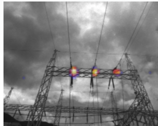
송전탑 전선 유지 보수 (다발성 부분방전)
