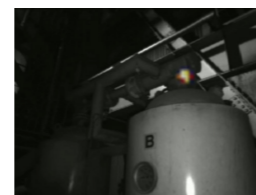
화학 가스 저장탱크 유지 보수 (가스 누설)
